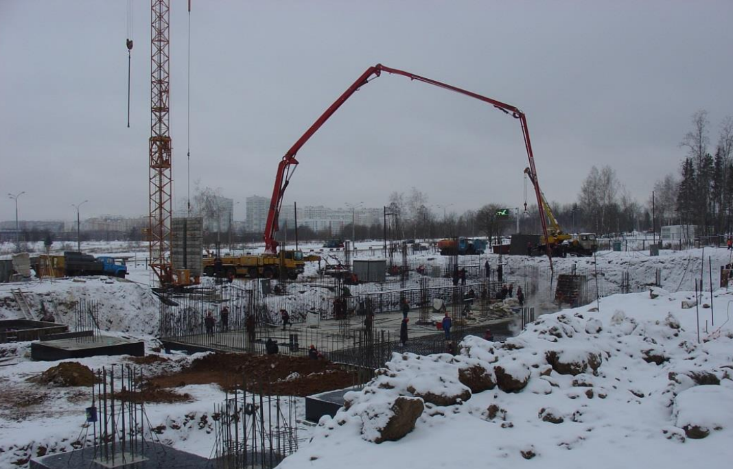
Общественно-торговый центр, корп.2314Б в 23 мкр.
